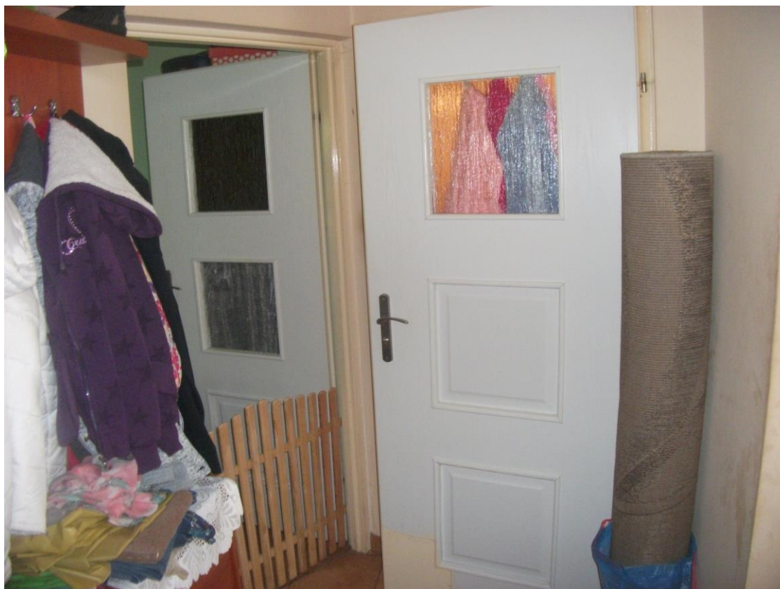
2. Skrzydło drzwi łazienki do wymiany
